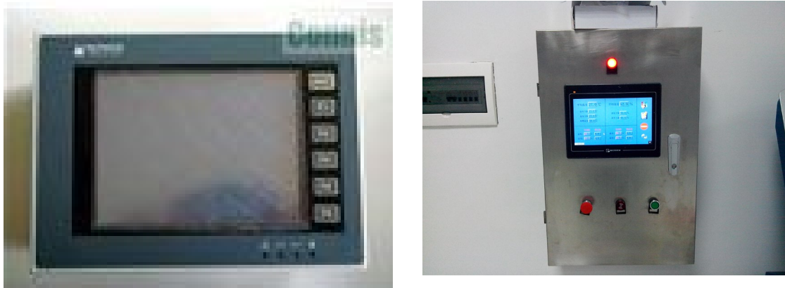
触摸显示屏及控制柜
